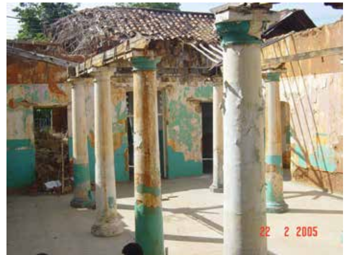
Deterioro de la Casa Pocaterra. Año 2005
