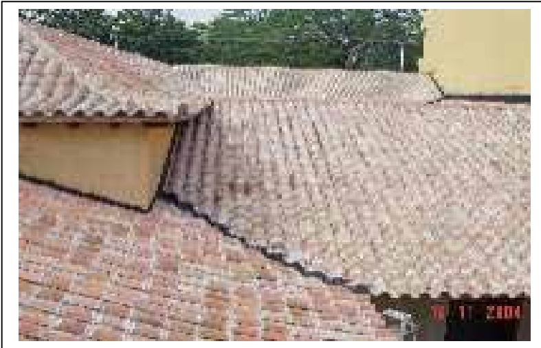
Vistas de la reconstrucción de aleros de madera y cubiertas con tejas artesanales de los techos 2002-3.
